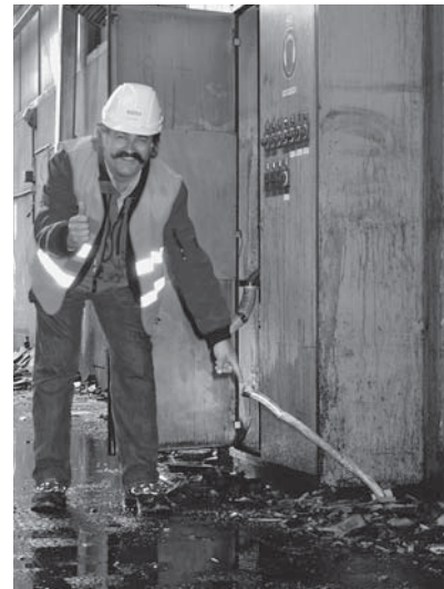
Fig. 1: on ne doit commencer des travaux de déconstruction que lorsqu'on est sûr que toutes les conduites ont été mises hors service.
