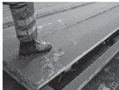
Fig. 4: attention au risque de rupture des couvertures, grilles, faux planchers, etc.!
