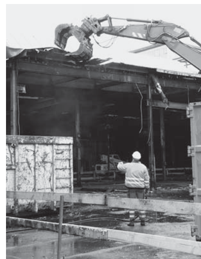
Fig. 3: l'accès à la zone dangereuse est barré et sécurisé par un poste d'alarme.
