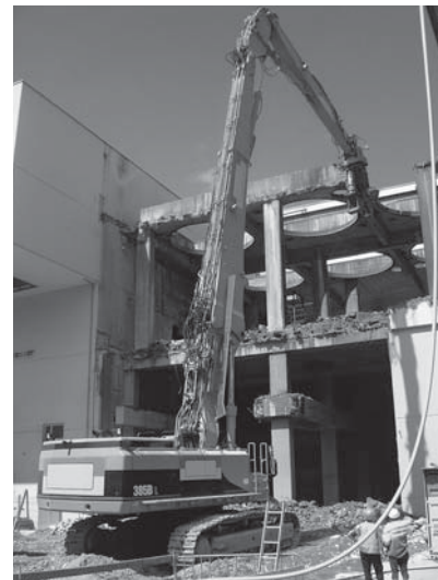
Fig. 2: en cas de travaux de démolition mécanisée, personne ne doit se trouver à proximité.
